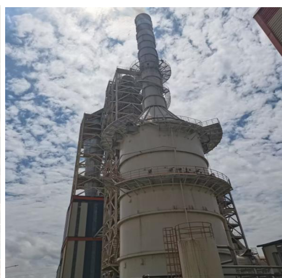
热能中心烟气排气筒
