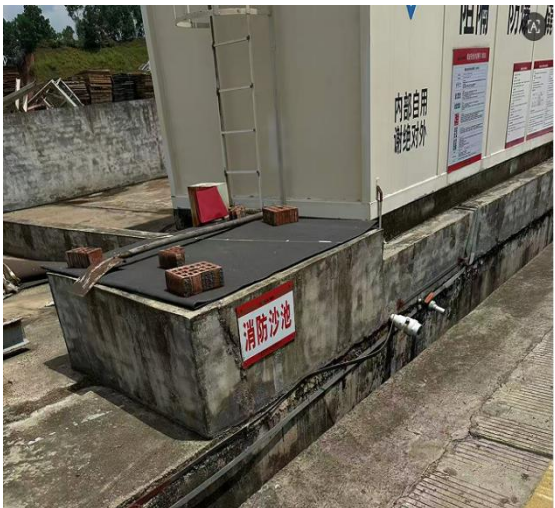
项目柴油储存区
