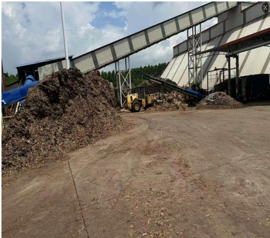
项目封闭木料传输线
