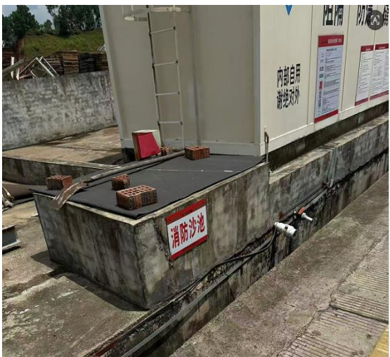
项目柴油储存区
