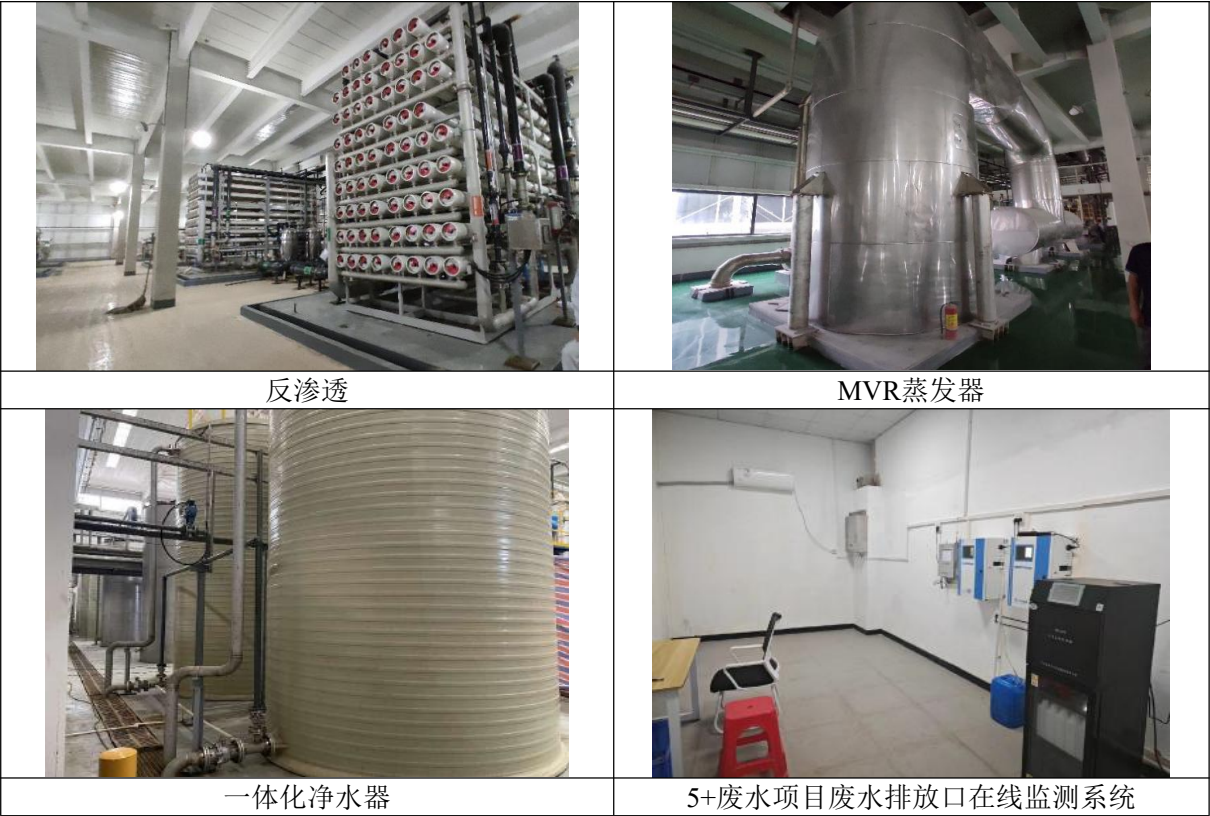
图 6.2-8 5+废水项目废水处理设施（依托）
