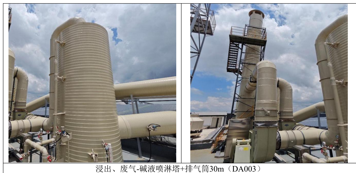
图 6.2-3 浸出废气处理设施
